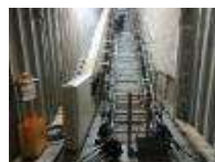
東西線大通駅のエスカレーター
