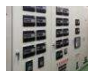
新さっぽろ変電所設備
