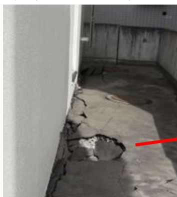
東豊線 元町駅の壁面部分が陥没
